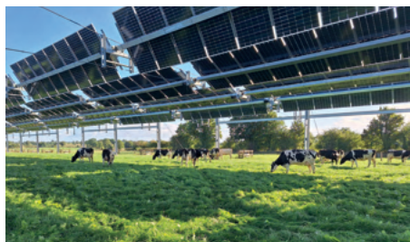
Photo 12 : Ombrières photovoltaïques à Souleuvre-en-Bocage (14) (@TSE)
