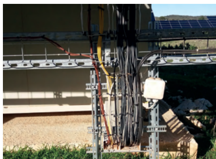
Photo 32 : Câblages laissés apparents (© Idele)
