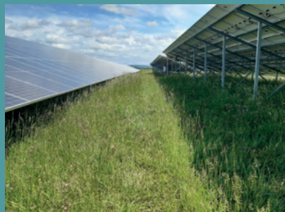
Centrale de Bioule (82) (© Ideler, centrale gérée par Neoen)
