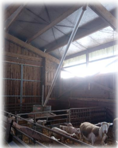
10 descentes nourrisseurs agneaux + installation électrique 7200 € HT en 2013
