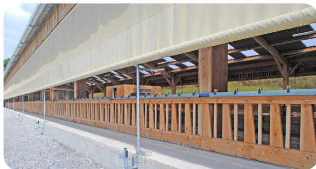
L'alimentation, entièrement mécanisée, est distribuée de l'extérieur
